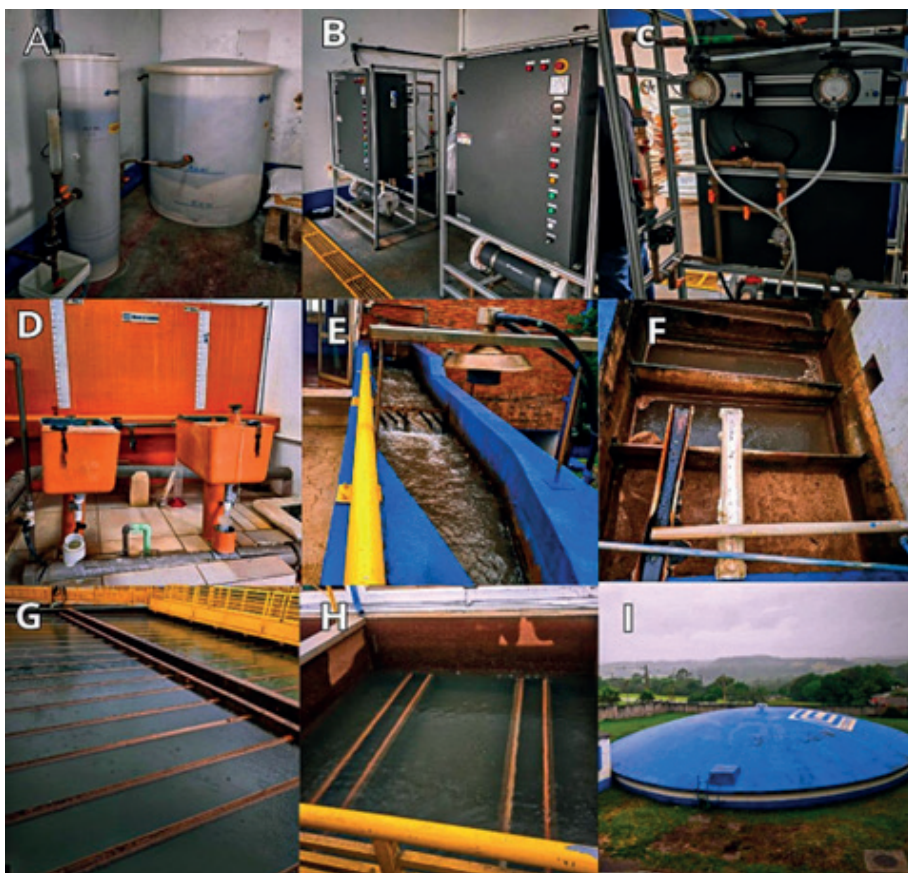
Figura 3 – Vistas das unidades de tratamento da ETA AEGEA/CORSAN
